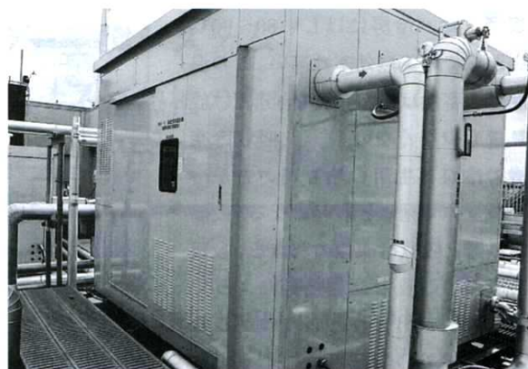
ソーラー・ガス併用熱源吸収冷水機は日立製
