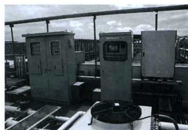
ソーラークーリングシステム制御盤(中央)と集熱運転状況などの表示盤(左)
