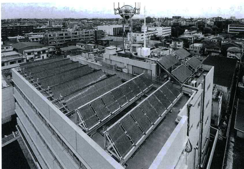
東京ガス・中原ビル屋上の太陽集熱器。(東京ガス提供)
