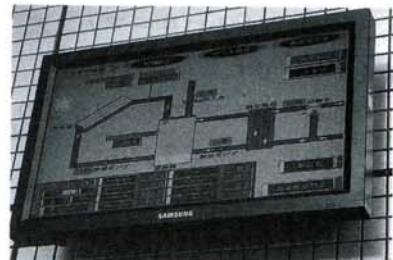
1階フロント壁面に設置された説明用ディスプレイ。
