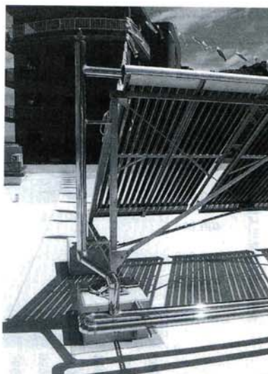
リバースリターン方式配管(下部)から集熱器への立上がり給水配管部。
